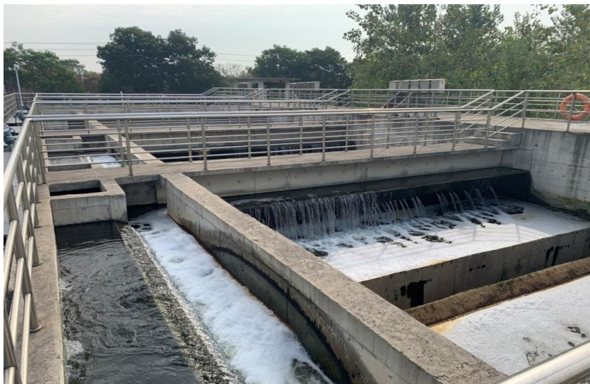
图 3.1-8 V 型滤池现状
